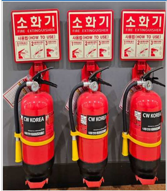
④ 소화기 위치표시 및 보관
