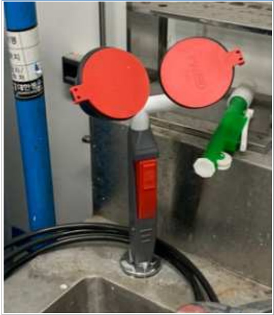
⑧ 아이 워셔기 설치
