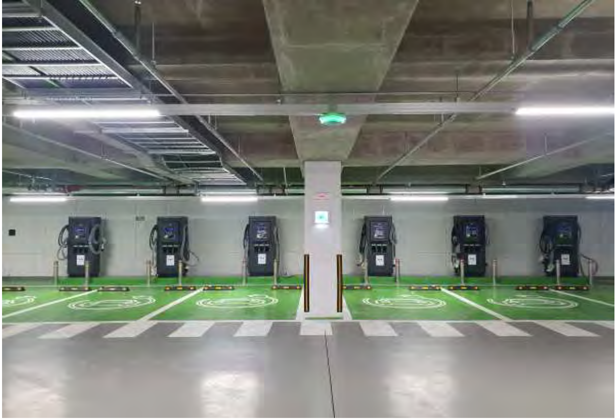
잔디광장 지하1층 주차장 급속충전기: 6대
