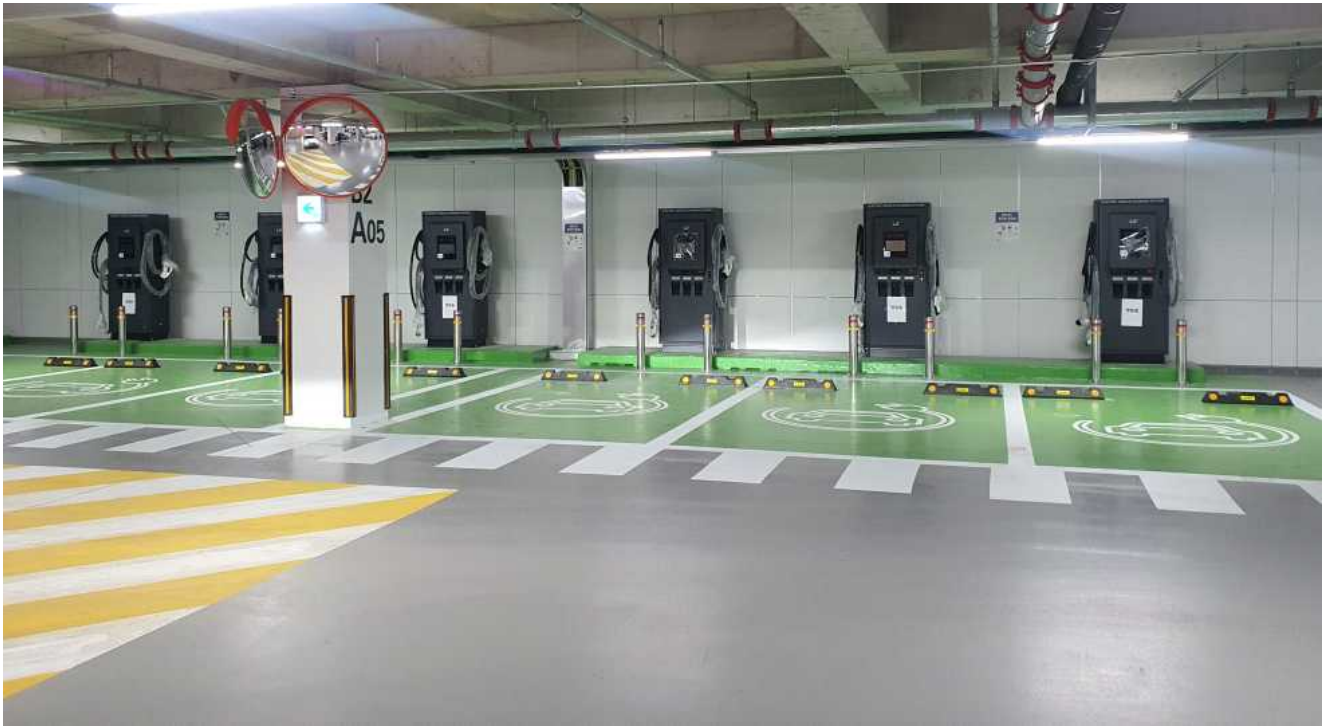
잔디광장 지하2층 주차장 급속충전기 6대
