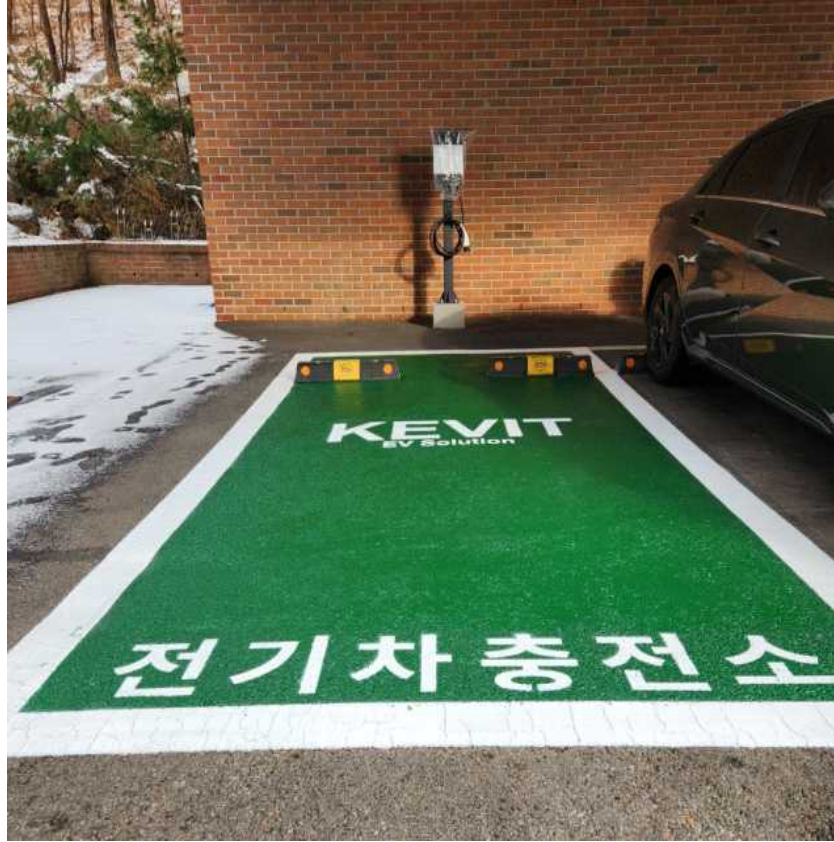
85-1동(수의생물자원연구동) 주차장 완속충전기 1대
