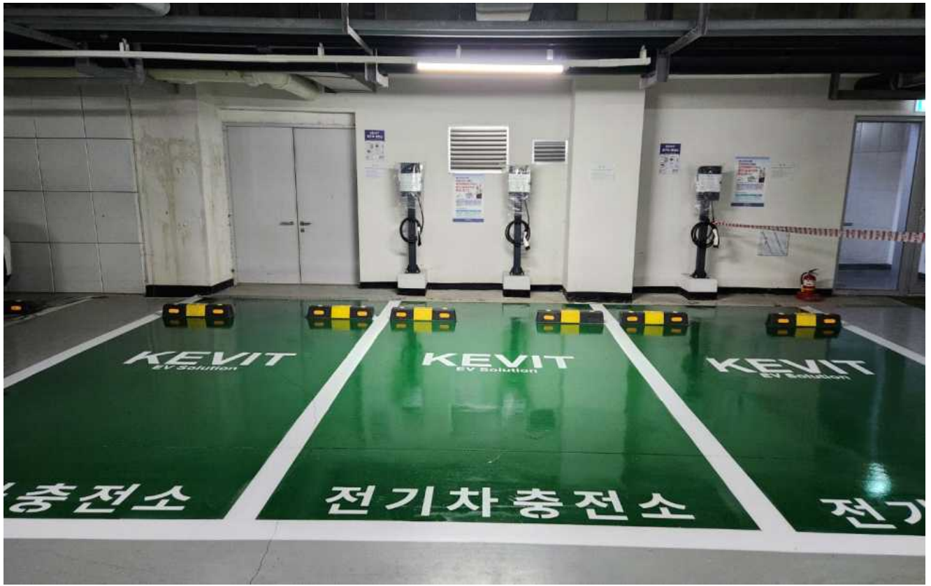
59동(LG경영관) 지하주차장 완속충전기 3대
