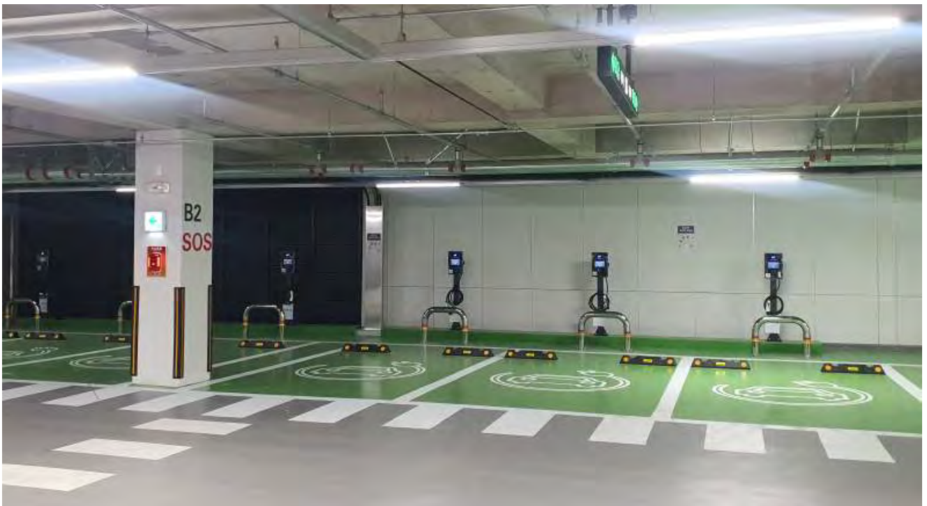
잔디광장 지하2층 주차장 완속충전기: 6대
