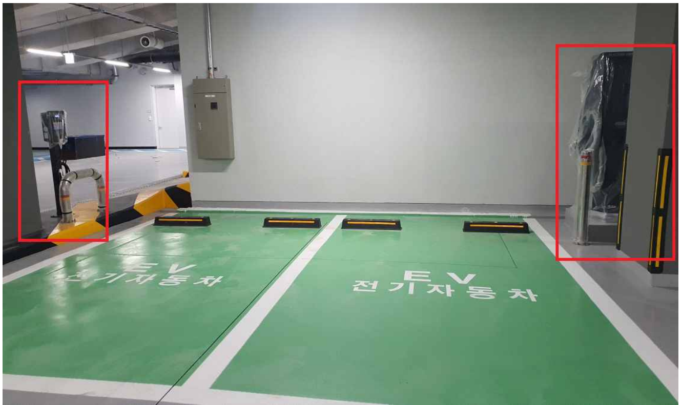
28동(자연대 대형강의동) 지하 주차장 완속충전기 1대, 급속충전기 1대
