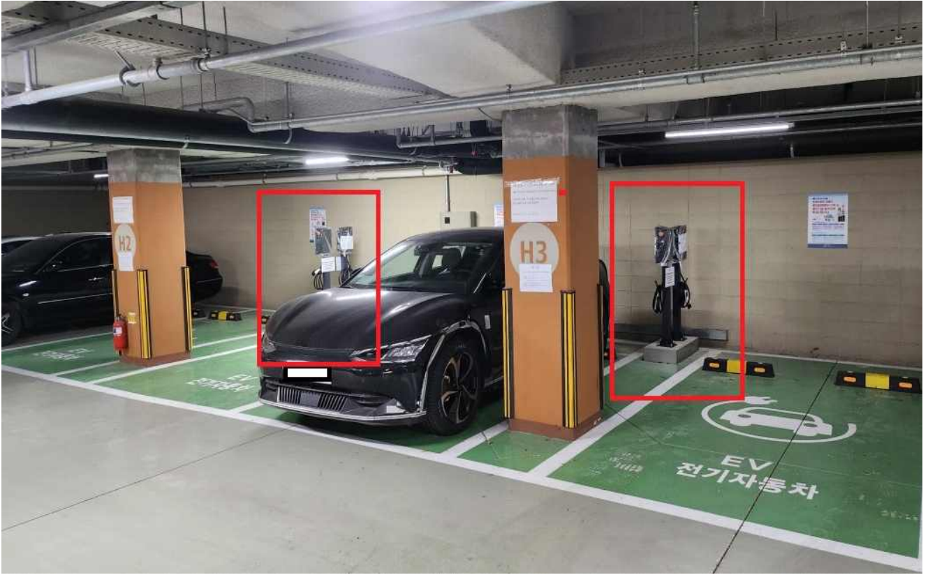
300동(유희진 학술정보관) 지하 주차장 완속충전기 4대
