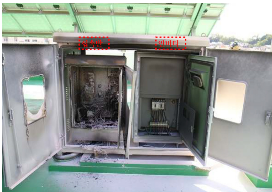
태양광 접속반, 인버터 연소형태
