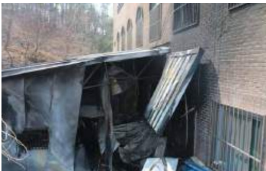
건물 뒤 보일러실 및 독서실 연소형태
