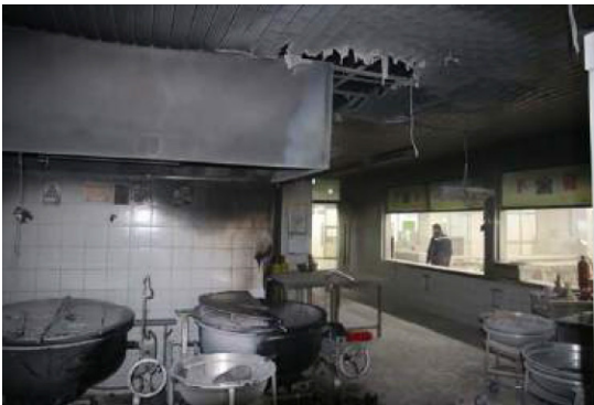
가스회전식국솥 및 천장일부 소실상태
