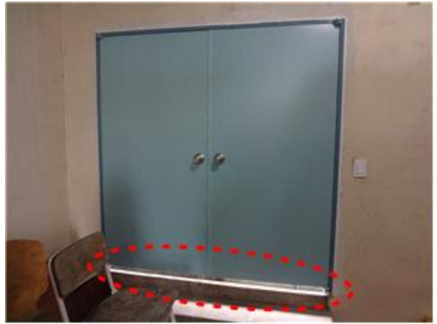
<출입문 기밀상태 불량>
