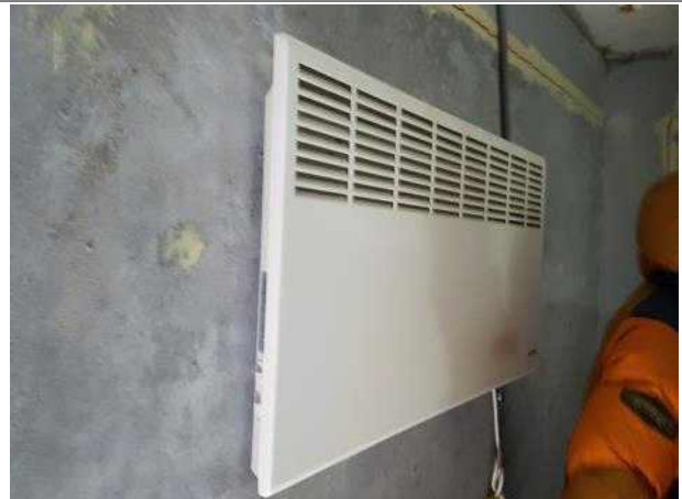
<물탱크실 동파방지 방열기 설치>
