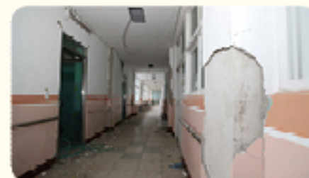
건물 내부 벽체 파손
