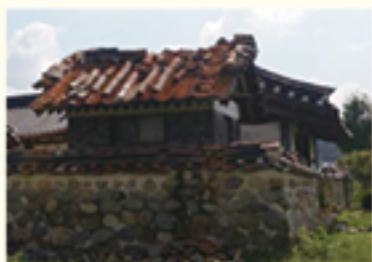
• 사마소 지붕 기와 파손
