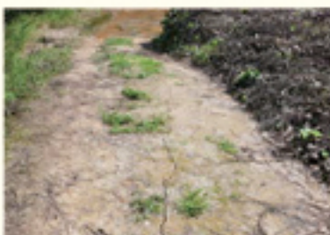
• 사곡지 저수지 둑 균열
