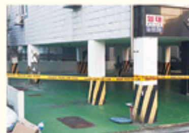
• 장량동 오서빌 필로티 파손
