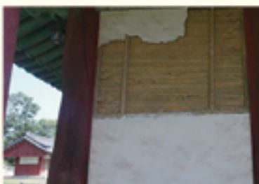
• 경주 향교 벽체 파손
