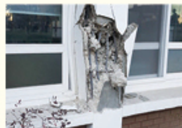
• 흥해초등학교 건물 기둥 파손
