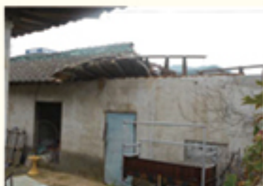
• 창고 지붕 파손
