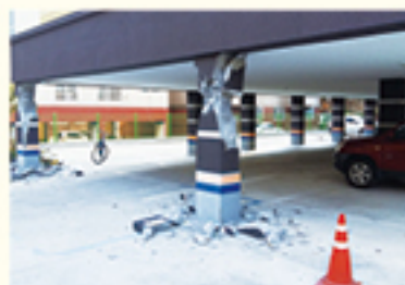
• 장량동 크리스탈 필로티 기둥 파손
